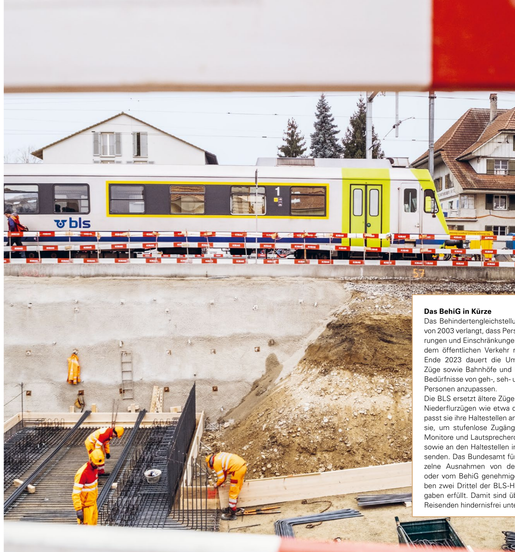
Die BLS erneuert in Kirchberg-Alchenflüh über zwei Kilometer Gleise, baut zwei neue Perrons sowie eine Unterführung und gestaltet den Bahnhofplatz neu.
