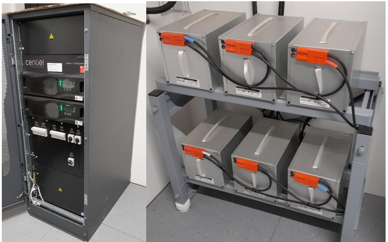
Abbildung 9 Neue USV-Anlage Centiel Cumulus Power im Stellwerk Steffisburg.
