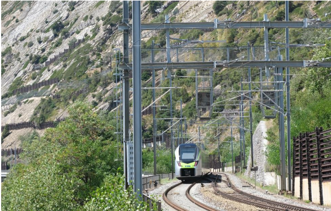
Abbildung 8 Fahrleitungssystem 01 auf der Lötschberg Südrampe
